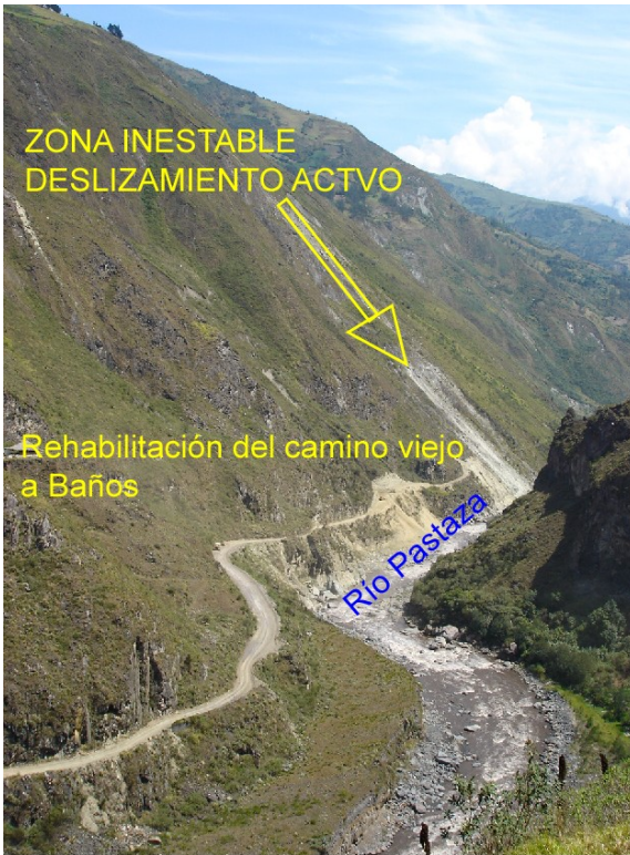
Fig.1. Maquinaria del Municipio de Patate realiza labores de apertura y rehabilitación del camino viejo Patate - Baños, en el sector de las Juntas Foto: DH.
