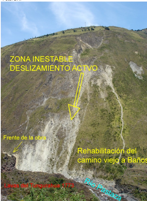
Fig.2. Vista general del deslizamiento desde la Pampa. Se observa los escarpes activos sin vegetación. Foto: DH.
