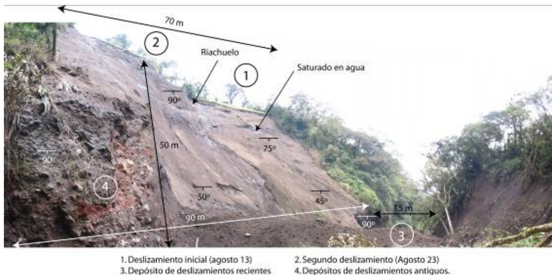
Fig. 12 Escarpe del deslizamiento de Nahuazo. El ancho del cauce del río a la altura del depósito es de 41 m.
