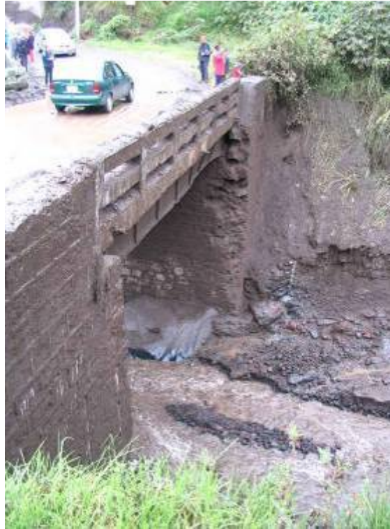
Fig. 10 El flujo transitó sobre el puente viejo del Vascún dejando un depósito de 20 cm de lodo sobre este. La viga horizontal del puente se encuentra doblada.
