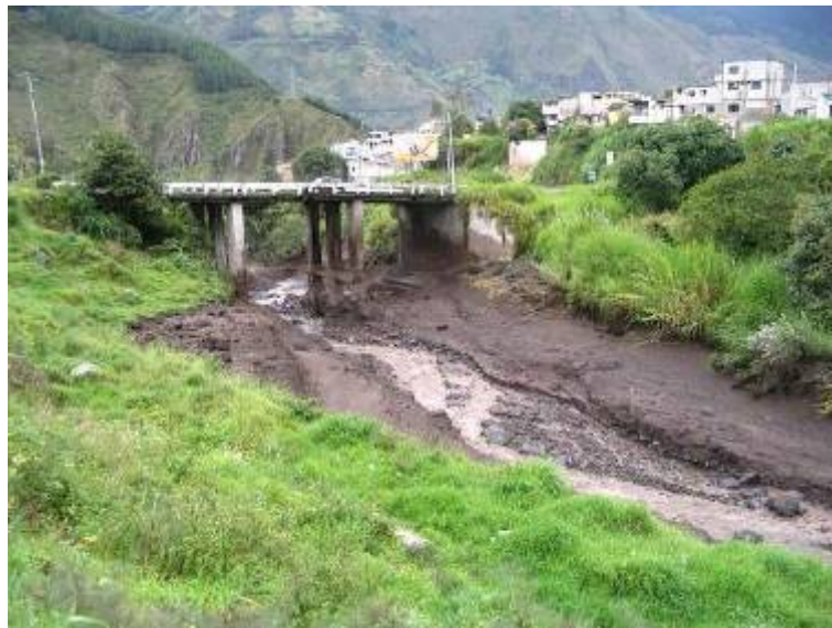
Fig. 11 Depósito del aluvión en el sector del puente principal de ingreso a Baños. El pilar central fue dañado por las rocas.
