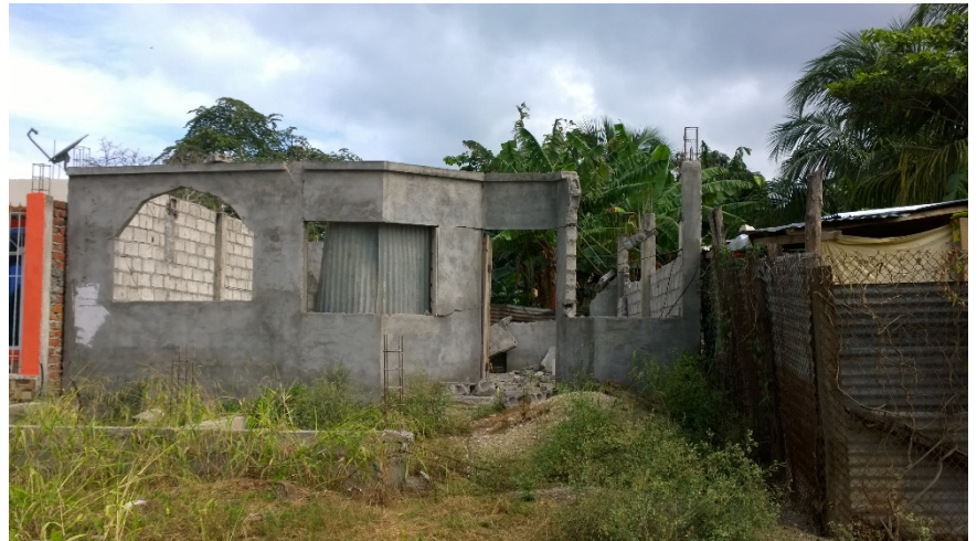
Figura 6. Daños en edificaciones Zona I (Tonsupa).
