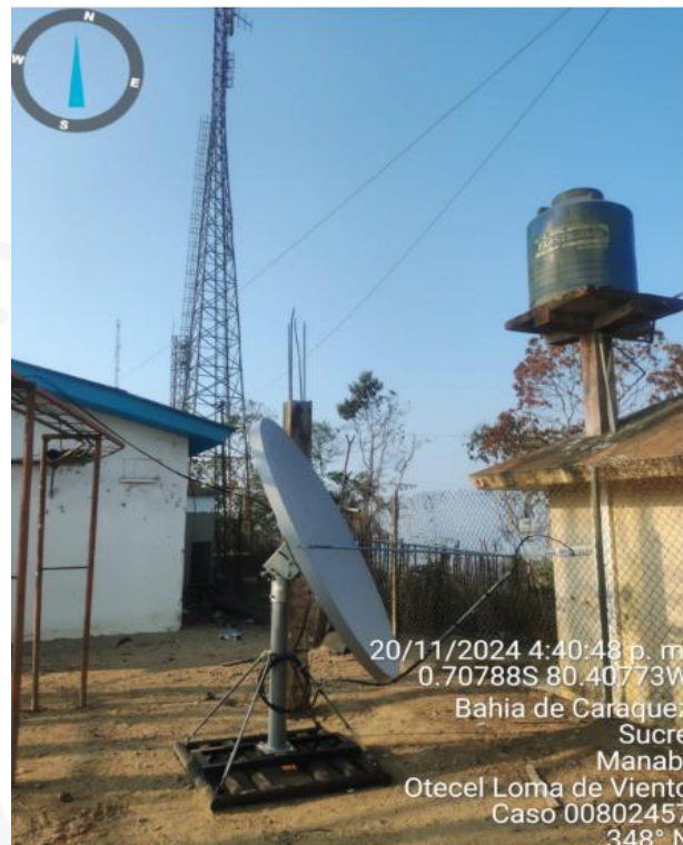
Figura 30. Estación satelital Loma de Viento - Noviembre 2024.
