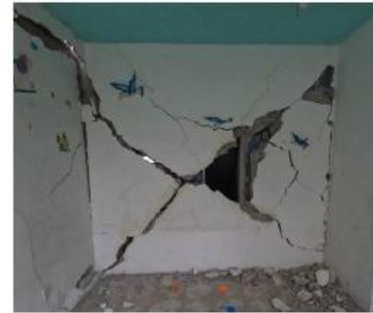
b) Grietas diagonales en pared interior
