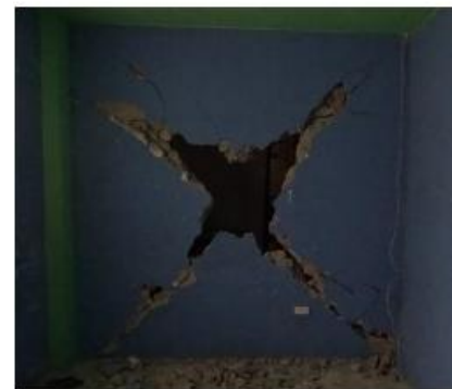
c) Grietas diagonales en pared interior
