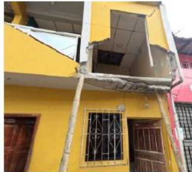
a) Colapso parcial de fachada
