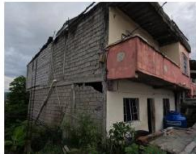
b) Asentamiento de la edificación
