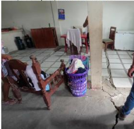
c) Grietas en pisos
