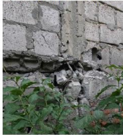
d) Fractura de columna
